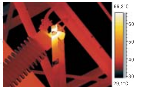
Fehlerhaft befestigte Verbindung
